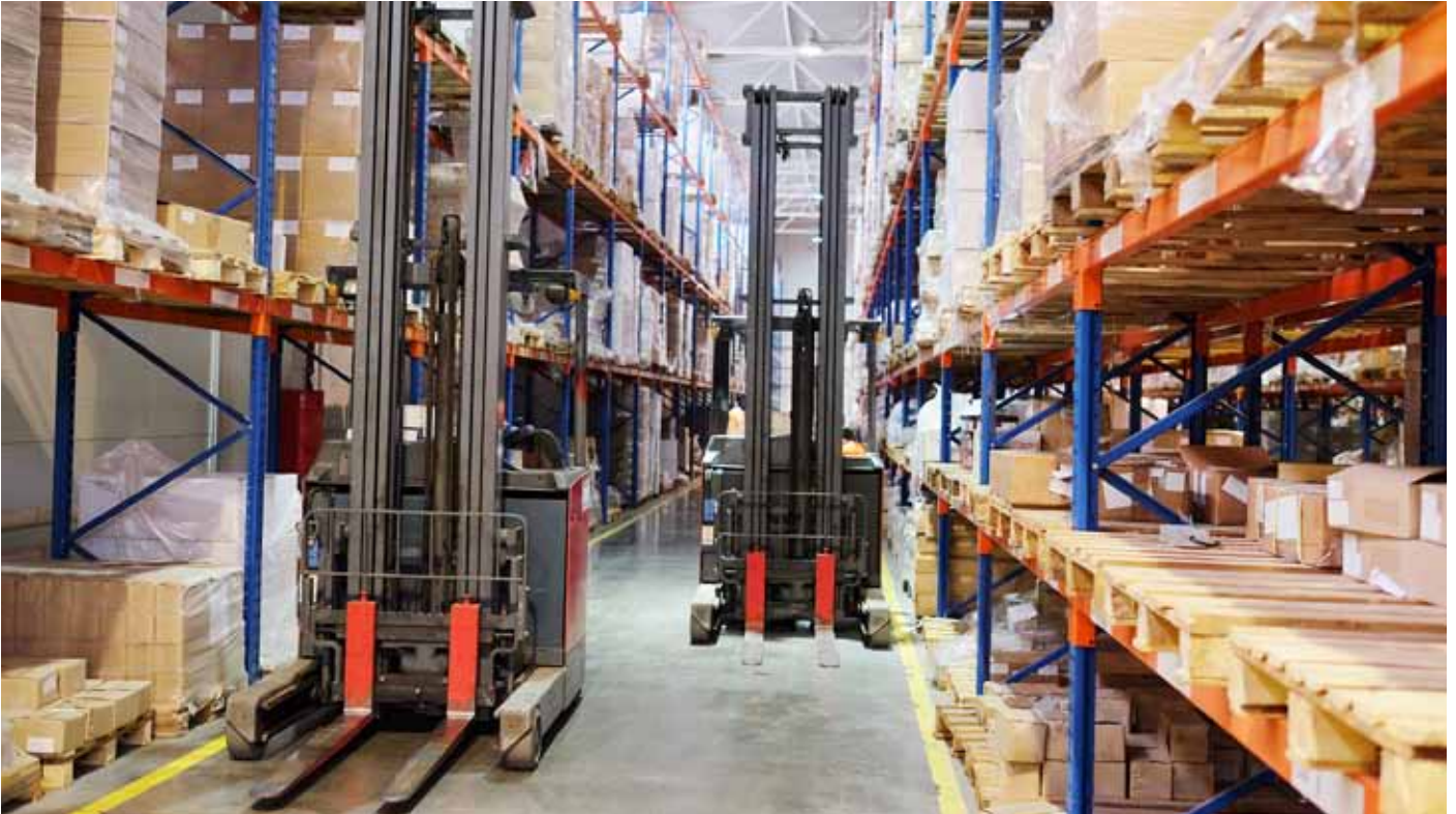
El almacenaje en estanterías de paletización se basa en el uso de carretillas para la carga y el picking.
